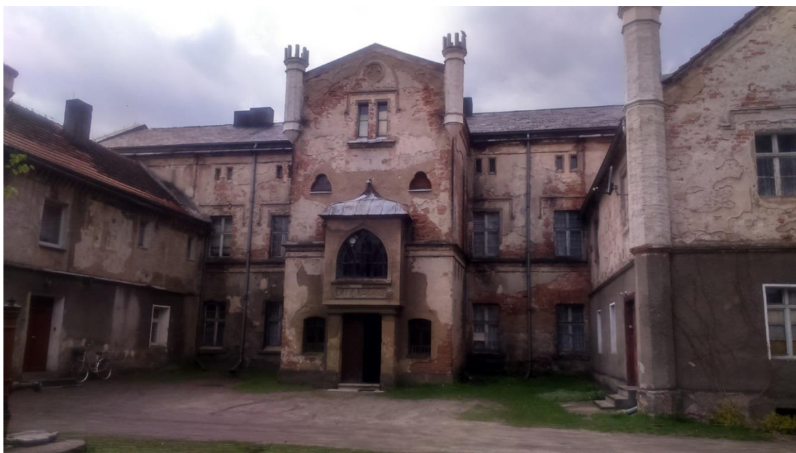
Rysunek 8 Budynek mieszkalny w Pomianach (dawny pałac) widok podwórza (źródło: Remedis SA)
